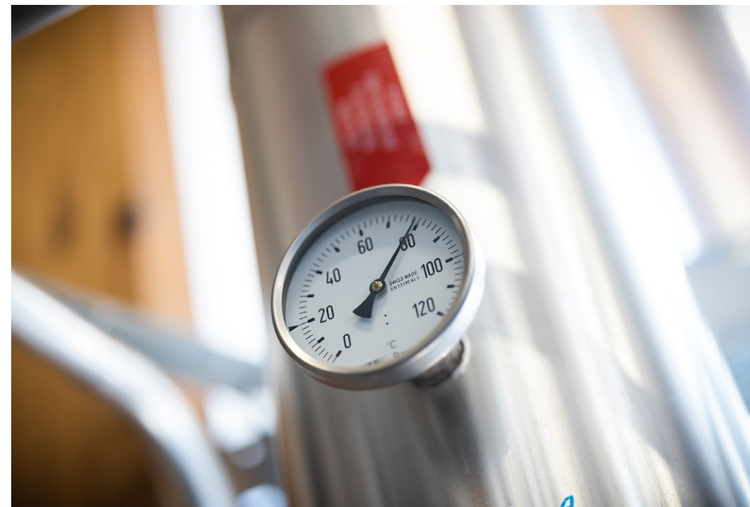
Anzeige: Dieses Thermometer kontrolliert die Temperatur des Vorlaufwassers für das Netz Süd. 80 Grad sind perfekt.
