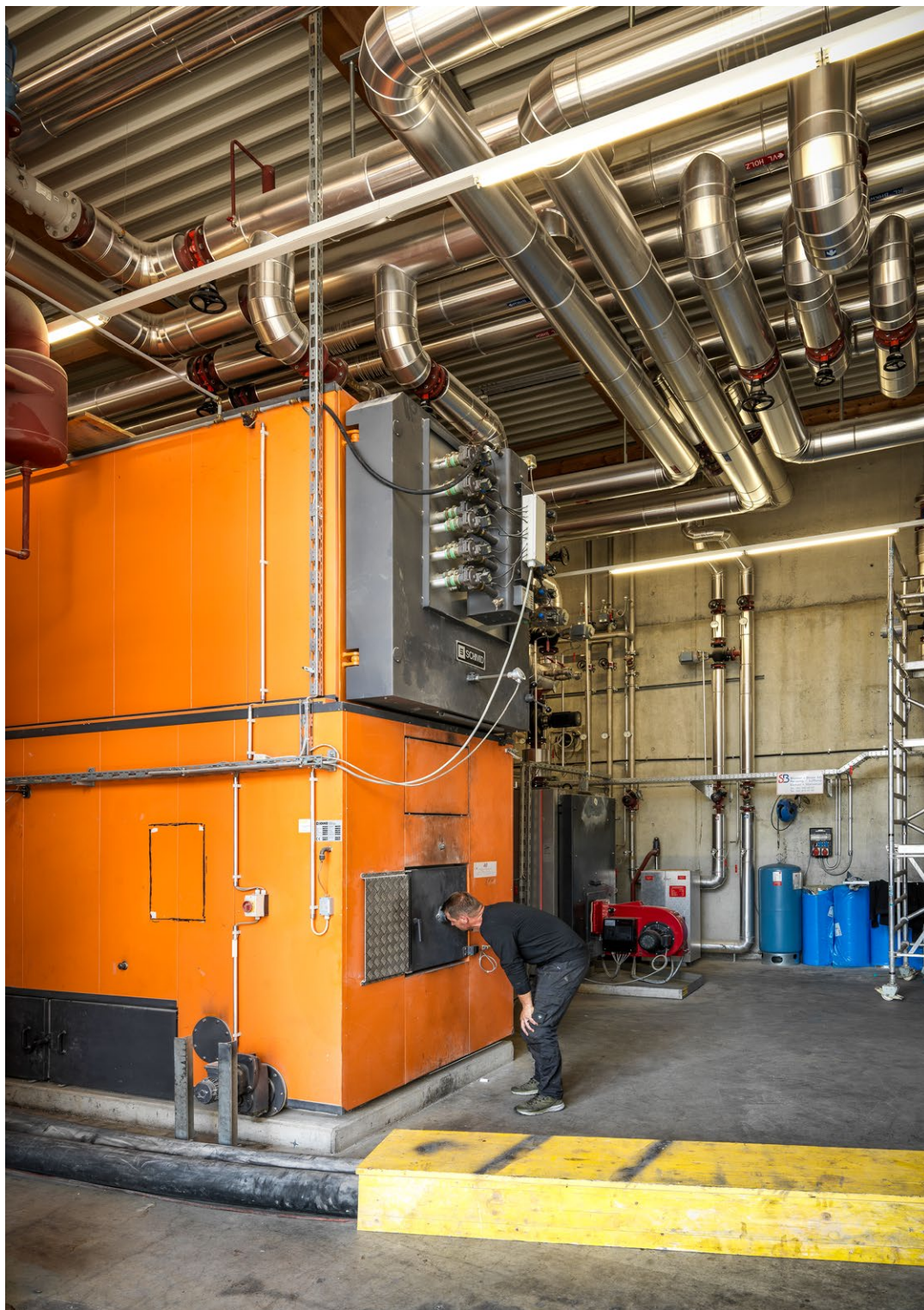
Der Ofen: Hier verglimmen die Holzschnitzel. Betriebsleiter Patrick Bader kontrolliert das Feuer durch das Guckloch.
