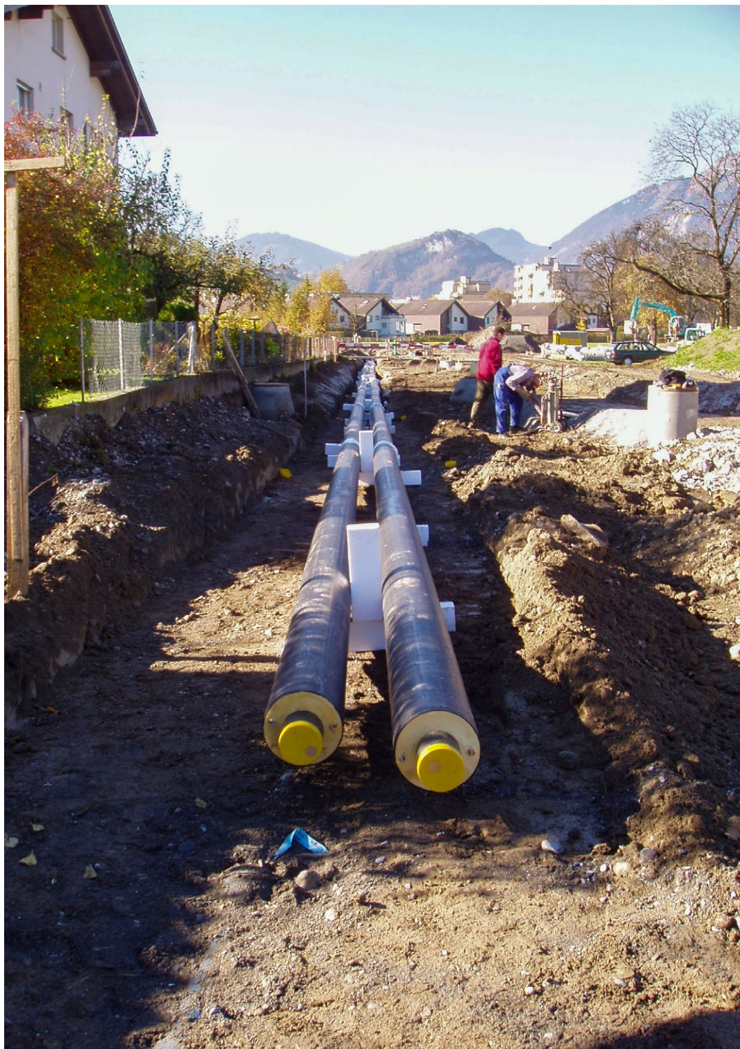
Mini-Pipeline: Das eine gut isolierte Rohr liefert heisses Wasser, das andere führt das abgekühlte Wasser zurück.
